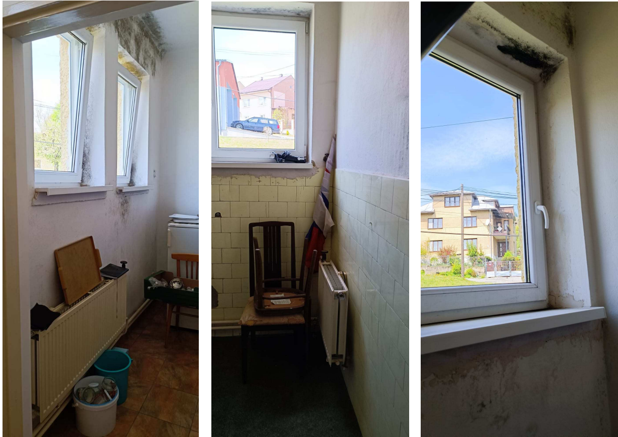
Obr. 17 Vo viacerých miestnostiach orientovaných severozápadným smerom sa na omietkach nadpraží okenných otvorov vyskytujú obrovské mapy kolónii plesní. Negatívne ovplyvňujú stavebné konštrukcie objektu. Okrem toho predstavujú obrovské zdravotné riziko pre človeka. Bude potrebná sanácia omietok aj muriva a stropov.
