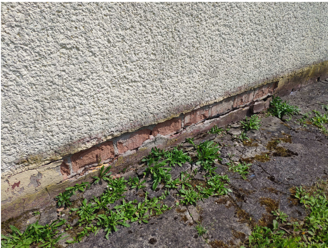
Obr. 22 Detailný pohľad na miesta, kde sa omietka základu aj murovaných konštrukcií odlupuje. Výrazné poškodenie povrchu obvodového muriva vplyvom nedostatočnej alebo žiadnej hydroizolácie spodnej stavby. Bude potrebná sanácia.
