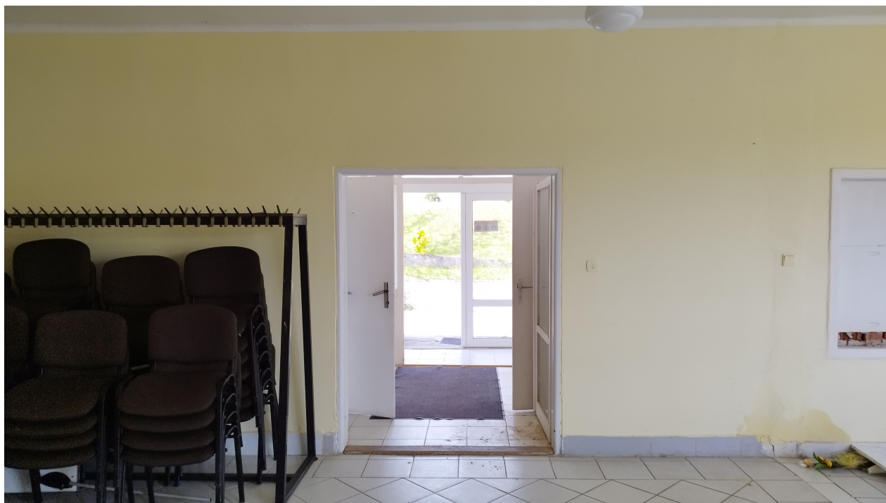
Obr. 14 Pohľad na vstup do sály objektu. V pravom dolnom rohu je vidieť zatekanie muriva kapilárnou vzĺnavosťou, vplyvom nedostatočnej alebo žiadnej hydroizolácie spodnej stavby. Bude potrebná sanácia.
