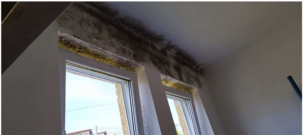
Obr. 18 Vo viacerých miestnostiach orientovaných severozápadným smerom sa na omietkach nadpraží okenných otvorov vyskytujú obrovské mapy kolónii plesní. Negatívne ovplyvňujú stavebné konštrukcie objektu. Okrem toho predstavujú obrovské zdravotné riziko pre človeka. Bude potrebná sanácia omietok aj muriva a stropov.
