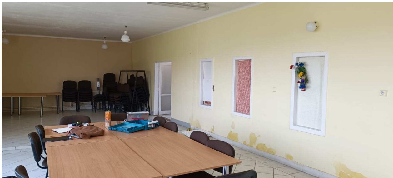
Obr. 15 Pohľad na sálu objektu. Je vidieť zatečené murivo kapilárnou vzlínavosťou, vplyvom nedostatočnej alebo žiadnej hydroizolácie spodnej stavby. Bude potrebná sanácia. V stenách sú viditeľné slepé niky, ktoré bude potrebné domurovať.
