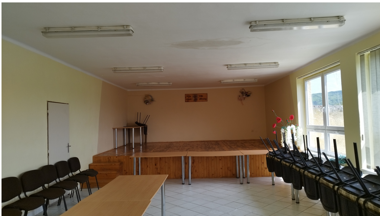
Obr. 16 Pohľad na sálu objektu s pódium. Je viditeľný lokálne zatečený strop objektu, priesak cez hydroizolačnú vrstvu strešnej krytiny. Bude potrebná sanácia.
